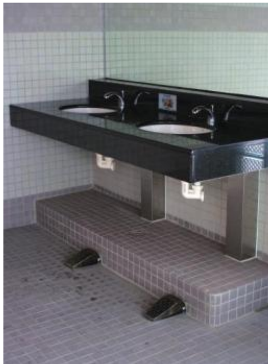
腳踏板給水式的洗手台
