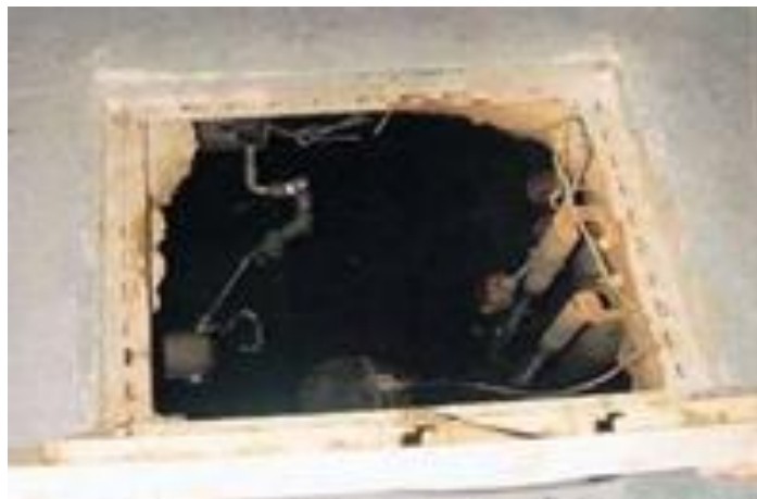
雨水儲集區之人孔位置
