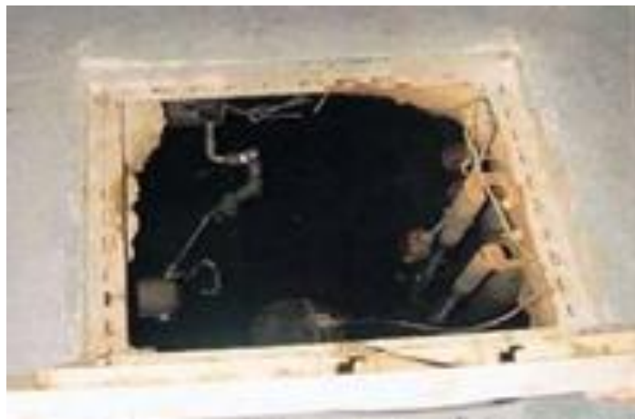
雨水儲集區之人孔位置
